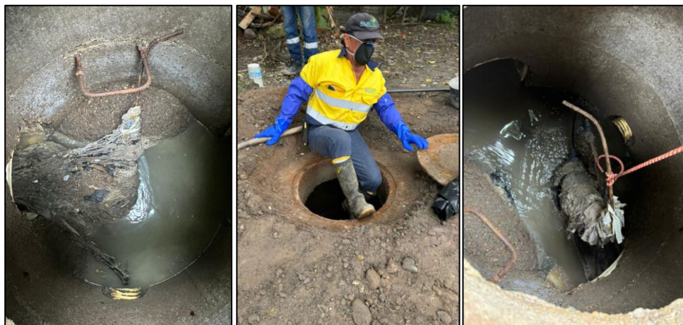
Ilustración 16 Alcantarillado sanitario barrio Brisas del Llano Empresa de servicios públicos de Restrepo Agua Viva S.A. E.S.P. Calle 1 Carrera 5A Barrio Minuto de Dios - Restrepo Meta – Cel. 3156903953 Web: www.aguavivaesp.gov.co Email: ventanillaunica@aguavivaesp.gov.co
